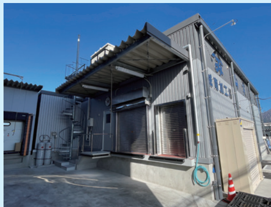
区分けされた搬出搬入口でスムーズな導線を確保
